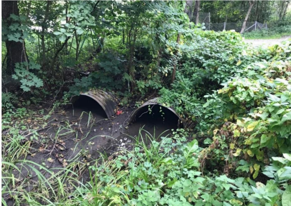
Figur 6. Trummorna under Garnuddsvägen var halvfylla med sediment. Foto: Björn Averhed
