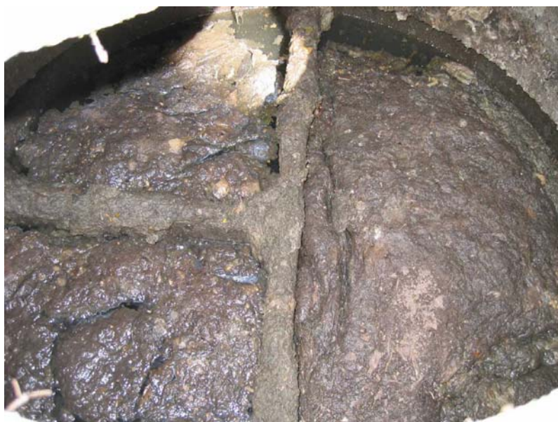
Bilden visar en äldre trekammerbrunn som inte har blivit tömd på ett tag. Brunnen ligger några meter från fastighetens recipient.
